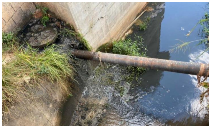
Figura 1: Interceptador do Córrego Bom Sucesso. Fonte: SAAE
